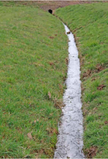
Gerade Bachläufe mit betoniertem Untergrund ohne Rückhaltemaßnahmen müssten neu gestaltet werden.
